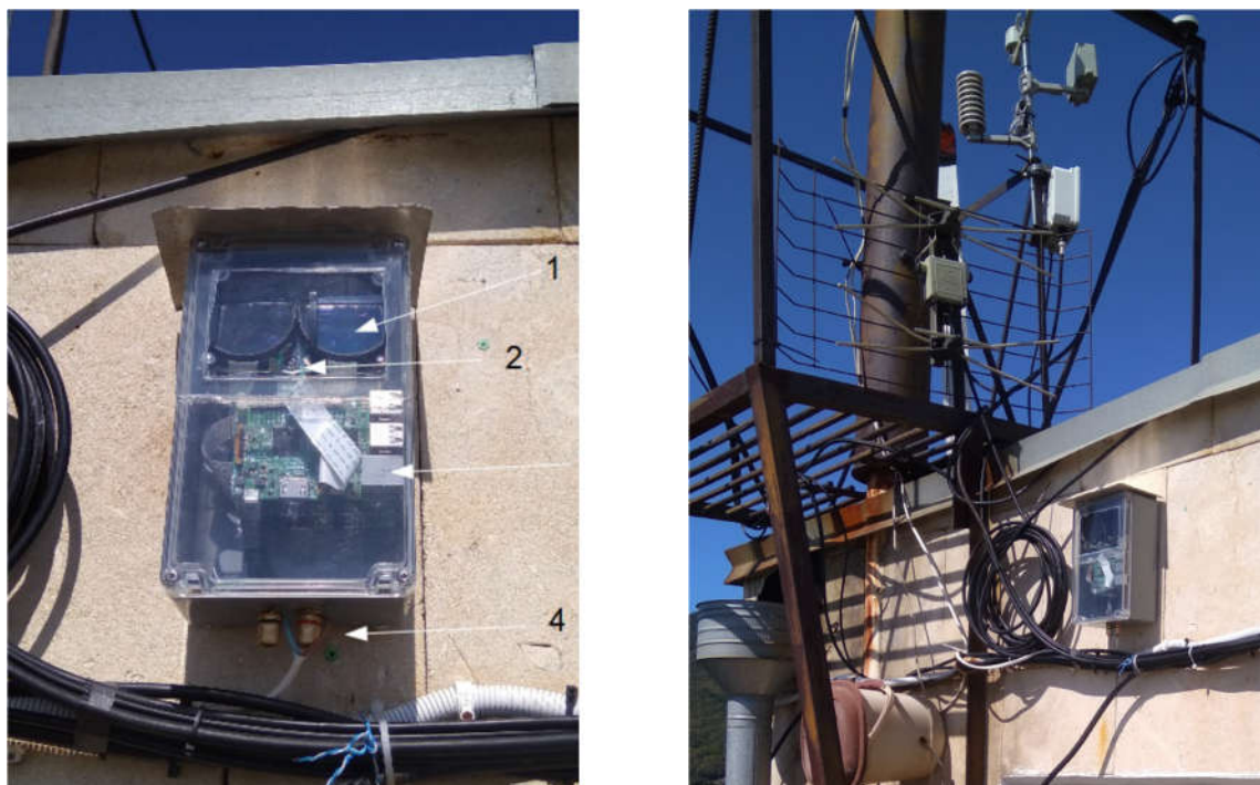
Рисунок 2.11.1 - Внешний вид аппаратуры и место ее установки на стене обсерватории.
